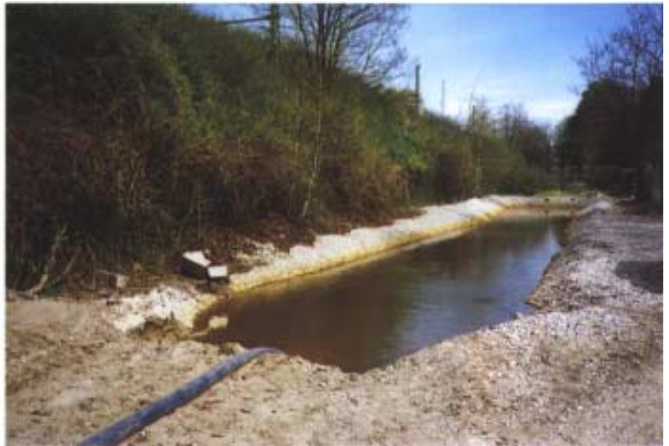
Abbildung 3: Sickerbecken in Betrieb, rote Färbung verursacht durch Eisen-Ausfällungen. (Foto. D. Tegtbauer, 1997).
